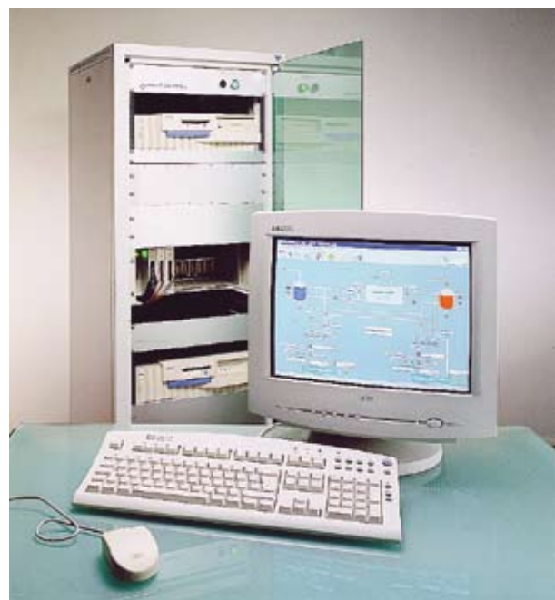
Rack di acquisizione dati e controllo.
